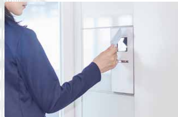
各階オフィスフロアカードリーダー
